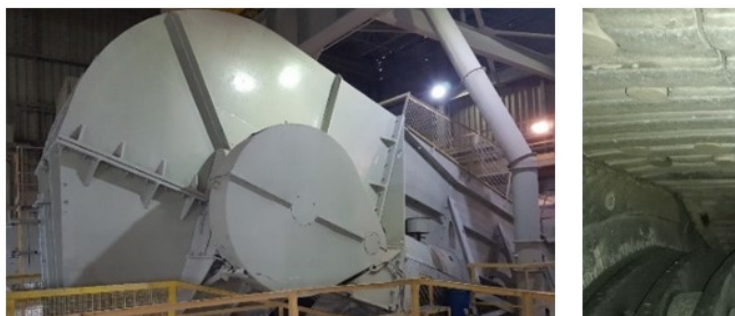
Rys. 10. Kruszarka Makrum 40.80: a)widok ogólny b)wnętrze z widokiem na płyty pancerne
